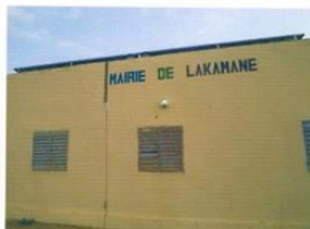
Photo N° 02: Vue arrière de la mairie et mise à la terre
