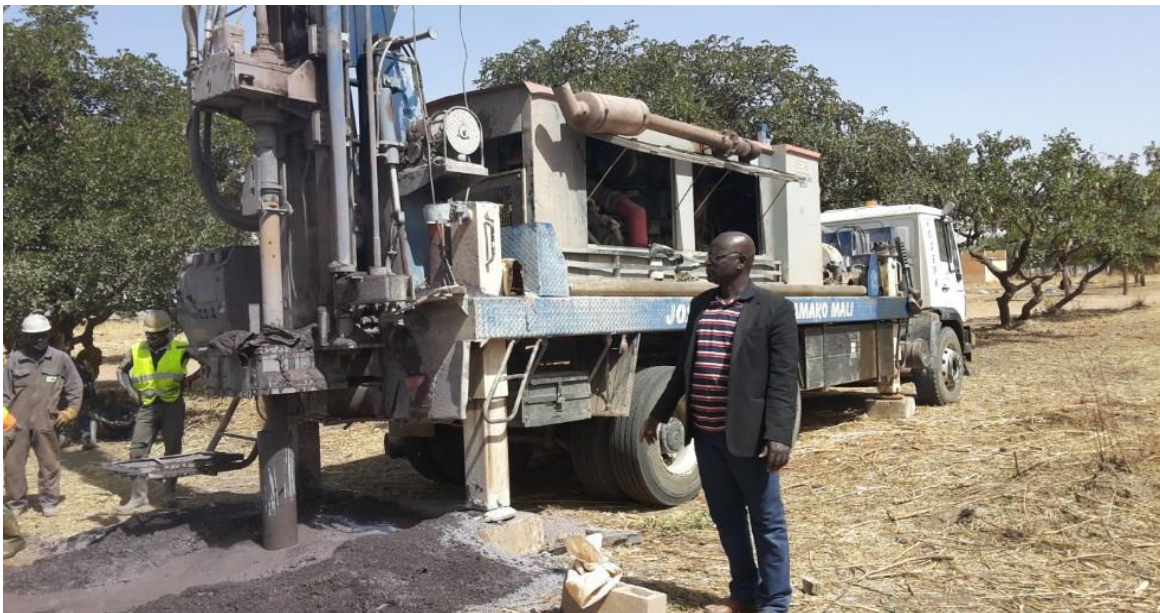
Le forage est un succès. Le maire de Lakamané a pu vérifier la présence de l'eau. L'ingénieur a certifié un débit de 3,5 m 3 /h
